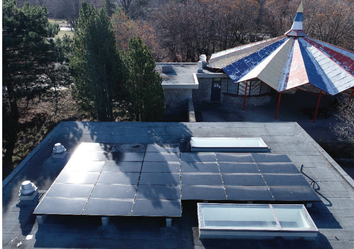
Panneaux solaires au parc Hog's Back
